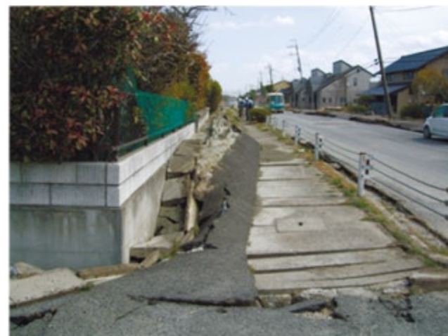
写真2-5 液状化による被害例1 （国土交通省関東地方整備局より引用） 液状化により地盤が沈下し、地中に埋設していた配管が浮き上がっています
