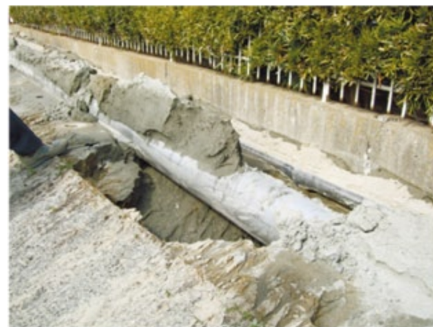
写真2-6 液状化による被害例2 （国土交通省関東地方整備局より引用） 浮き上がった配管の拡大写真です。噴出した砂も見えます。
