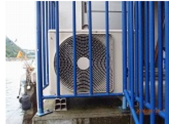
エアコン室外機
