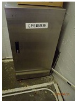
GNSS 観測機器の収納箱
