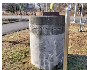
突出マンホール (北海道釧路町)
