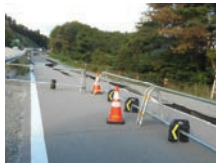
【図③：道路陥没状況】
