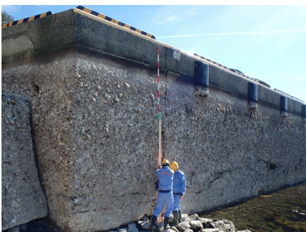
写真-6 鹿磯漁港（輪島市）における現地調査の様子（約4mの隆起）
