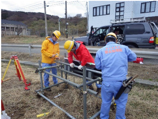
写真-4 小型GNSS観測装置「七浦(しつら)」設置風景。 1月20日設置。
