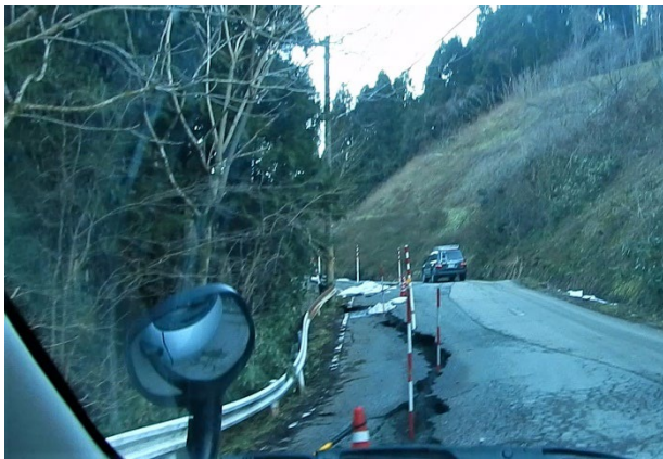
写真-1 道路の被災状況。
