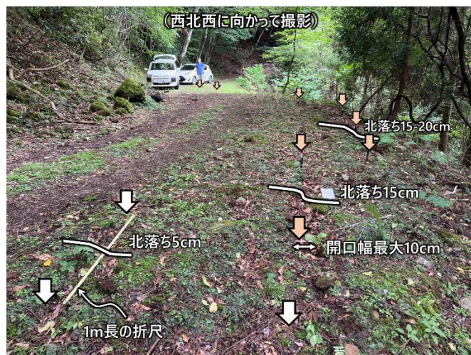
図-2 現地で確認した地表地震断層と推定される開口亀裂．杭やペグの位置（薄橙色矢印）や白矢印の位置に開口亀裂が分布する．亀裂の東端から西北西に向かって撮影．写真手前の亀裂の走向が N65^{\circ}\sim 70^{\circ}W ．いずれの亀裂も北落ちの上下変位で現地計測変位量を写真中に記載．
