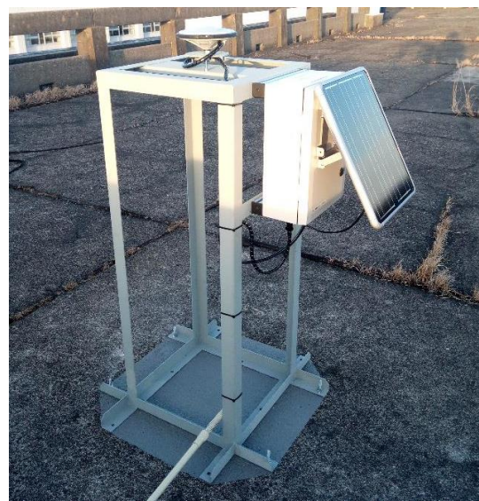
写真-1 設置例（千葉県いすみ市）
