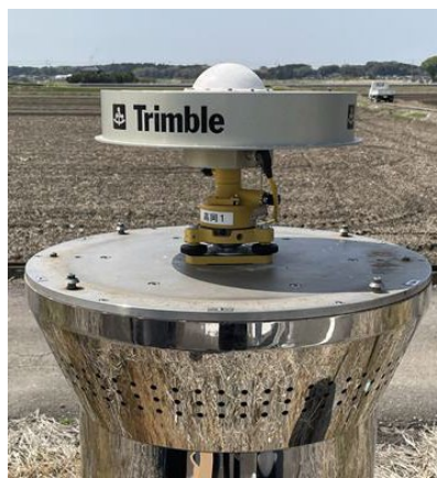
チョークリングアンテナの設置状況
