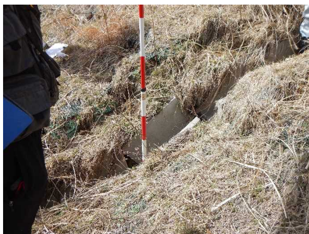
写真-2 地点1で確認した地表変位に伴う水路の変形
