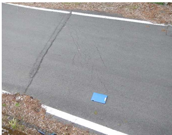
写真-3 地点3で確認した道路補修箇所の新たな亀裂
