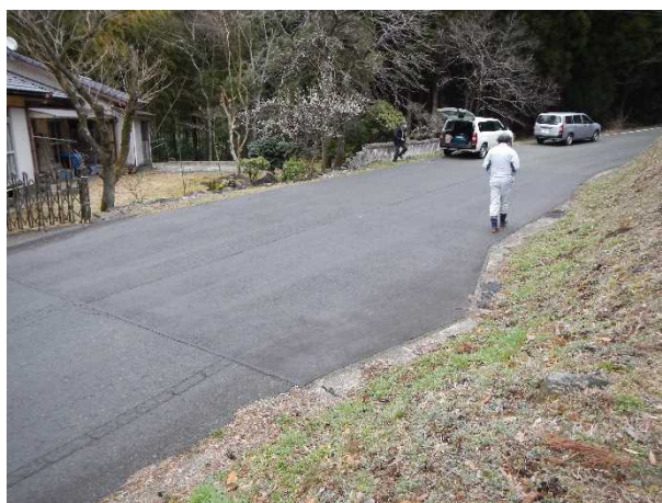
写真-6 地点5で確認した道路補修痕
