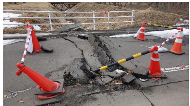
写真-1 図-4 中 A 地点の道路の変形
