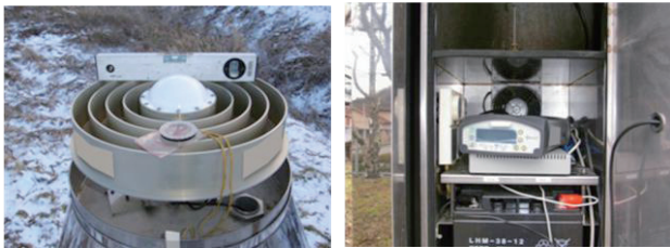
図-5 更新作業中のアンテナ (左) と GNSS 受信機 (右).
