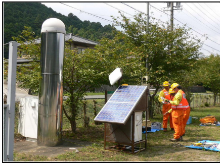
写真-1 M日坂に併設された可搬型 REGMOS
