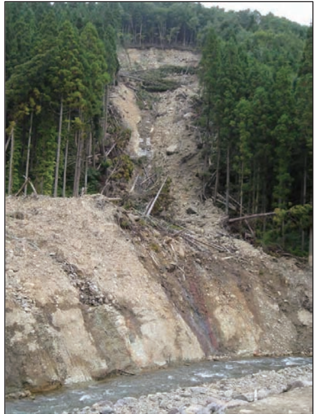
写真-3 行者滝付近の崩壊
