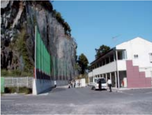
写真-12 落石現場の切り土斜面の状況
