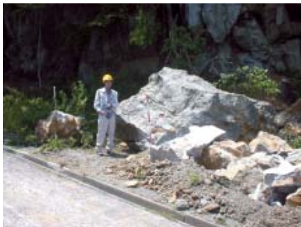
写真-10 落石による石灰岩の岩塊
