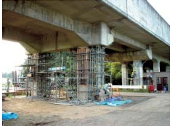
写真-7 新幹線橋脚の損傷の状況
