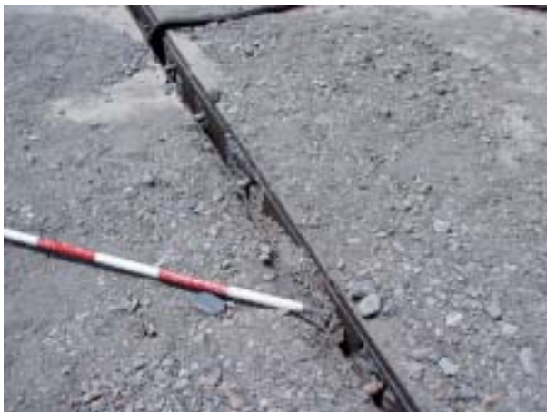
写真-8 液状化による噴砂
