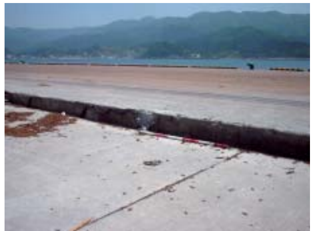
写真-9 地震による段差の発生
