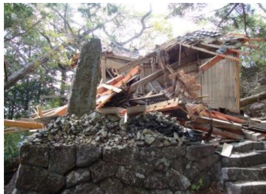
台風で崩壊した奥の院
