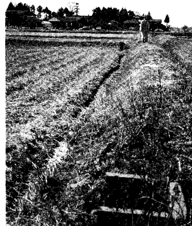
写真-10 用水路沿いの地割れ (笹神村高田-上高田)
