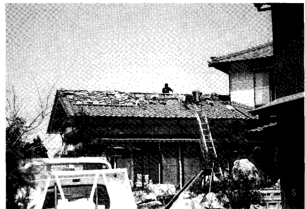
写真-4 屋根瓦の最上部の落ちた家屋 (笹神村高田)
